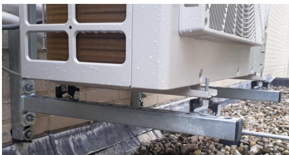
f 7.2 Warmtepomp op rubberen trillingdempers
