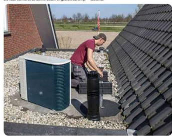
Een hybride warmtepomp wordt samen met je huis geïnstalleerd.
